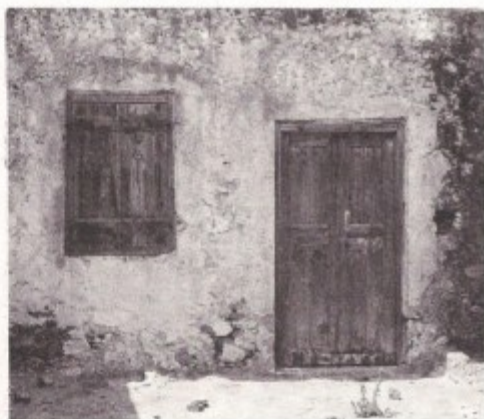
(Φωτ. 16) Εξωτερικά κανάτια
