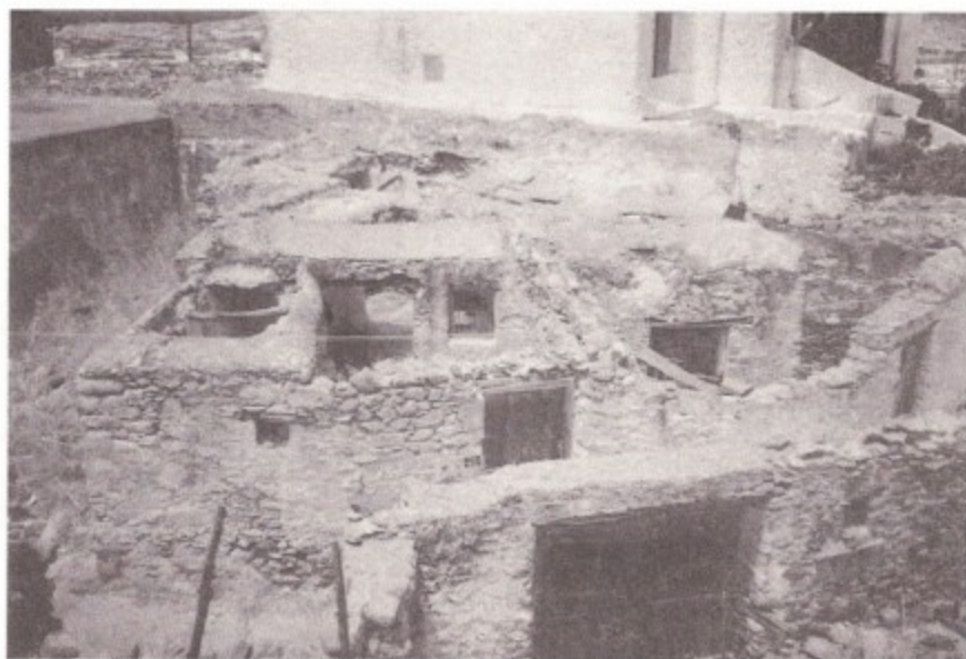
(Φωτ. 5) Ερημα, εγκαταλελειμμένα σπίτια στον «Δέχτη»
